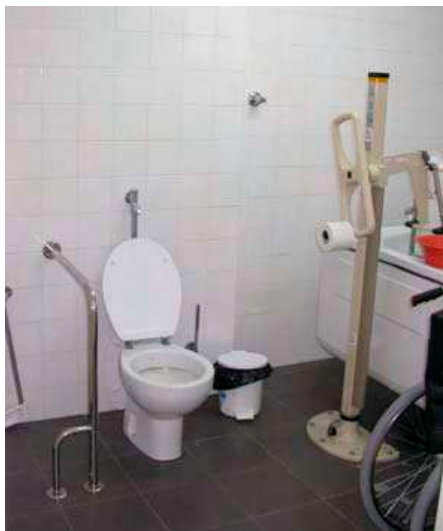
Fig. 5.35 – No banho assistido existe retrete mas não existe lavatório
