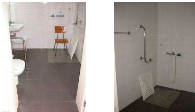
Fig. 5.29 - Instalações sanitárias com duche - tiveram de ser improvisadas grelhas e cadeiras
